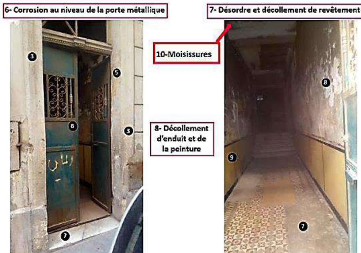
Fig.44. La suite des pathologies de l'immeuble bâti n°8
