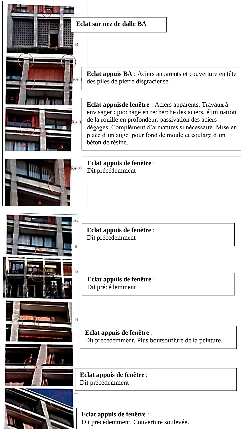
Fig.66 : Diagnostic technique : repérage et description des pathologies des enveloppes verticales, 2010 (source : Graf & Delemontey, 2020)
