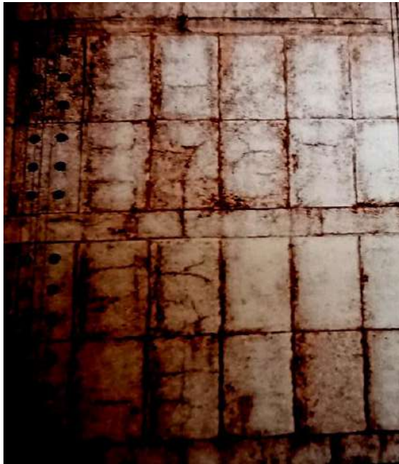
Fig.53. Etat de dégradation des plaques de revêtement en Contex de la façade ouest, en 1991 (source : Graf & Delemontey, 2020)
