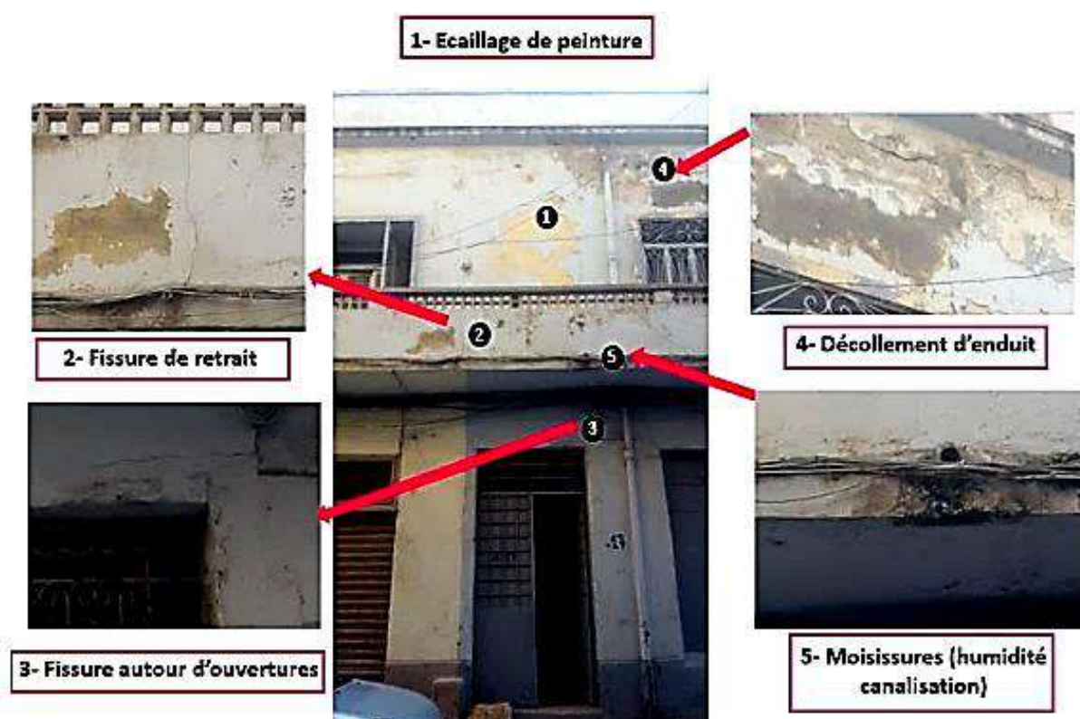
Fig.45. Les pathologies de l'immeuble bâti n°9
