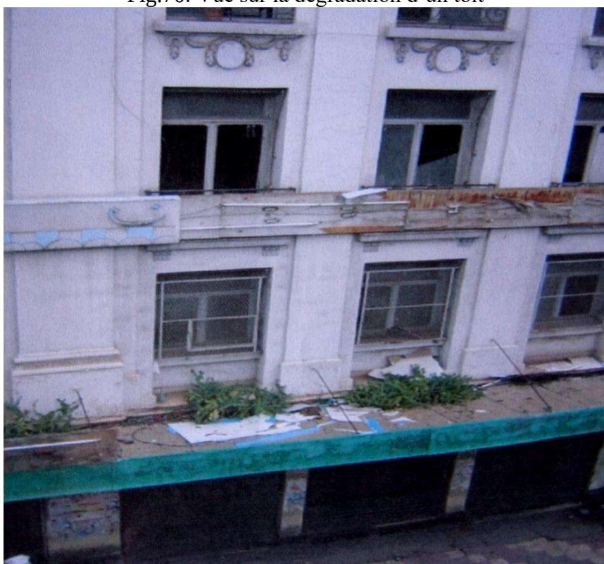
Fig.71. Vue sur la dégradation d'une corniche
