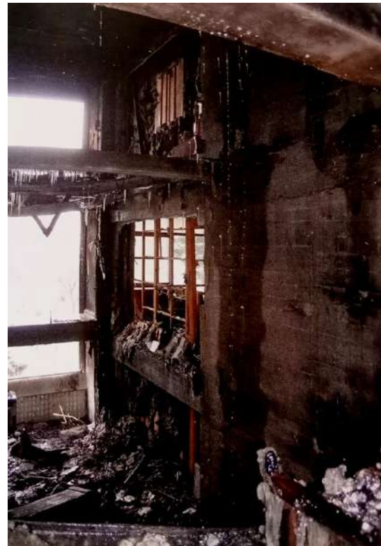
Fig.54. Appartement après l'incendie, 2012 (source : Graf & Delemontey, 2020)
