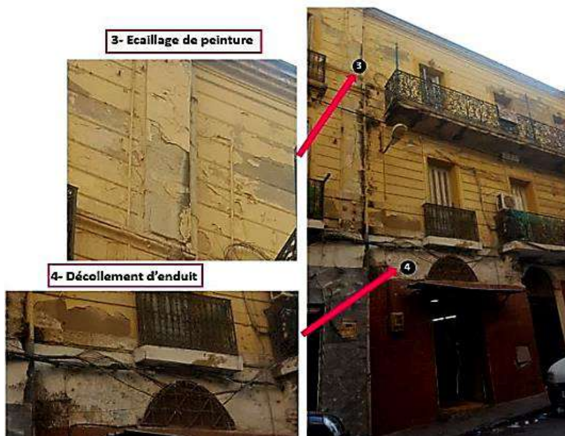
Fig.37. La suite des pathologies de l'immeuble bâti n°5
