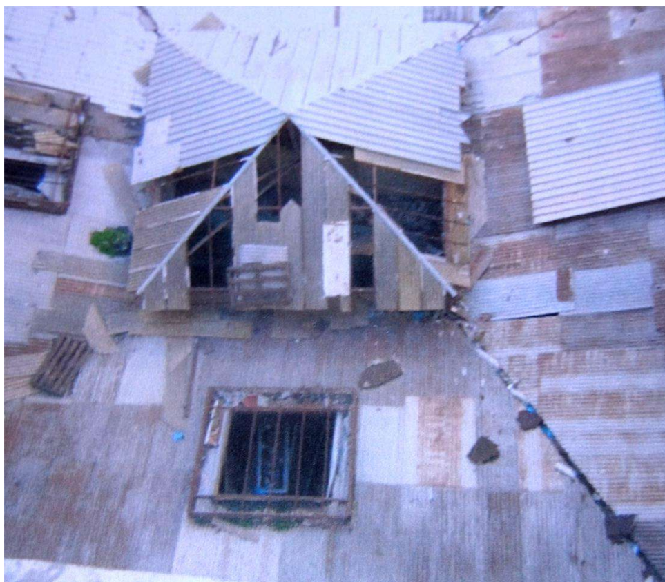
Fig.70. Vue sur la dégradation d'un toit
