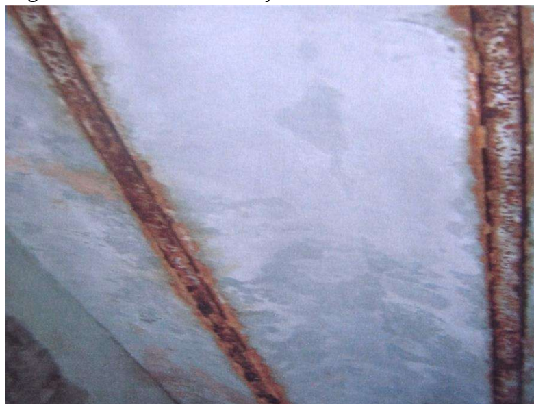
Fig.67. Corrosion avancée des profilés métalliques au niveau des planchers
