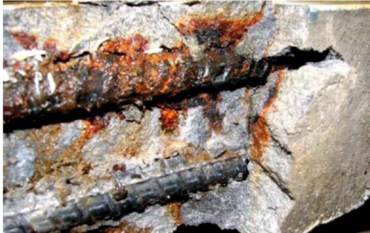
Fig.21. Corrosion des armatures. Source : Abou Chakra, 2016
