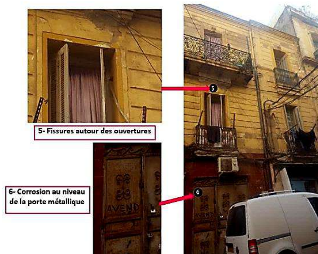
Fig.38. La suite des pathologies de l'immeuble bâti n°5
