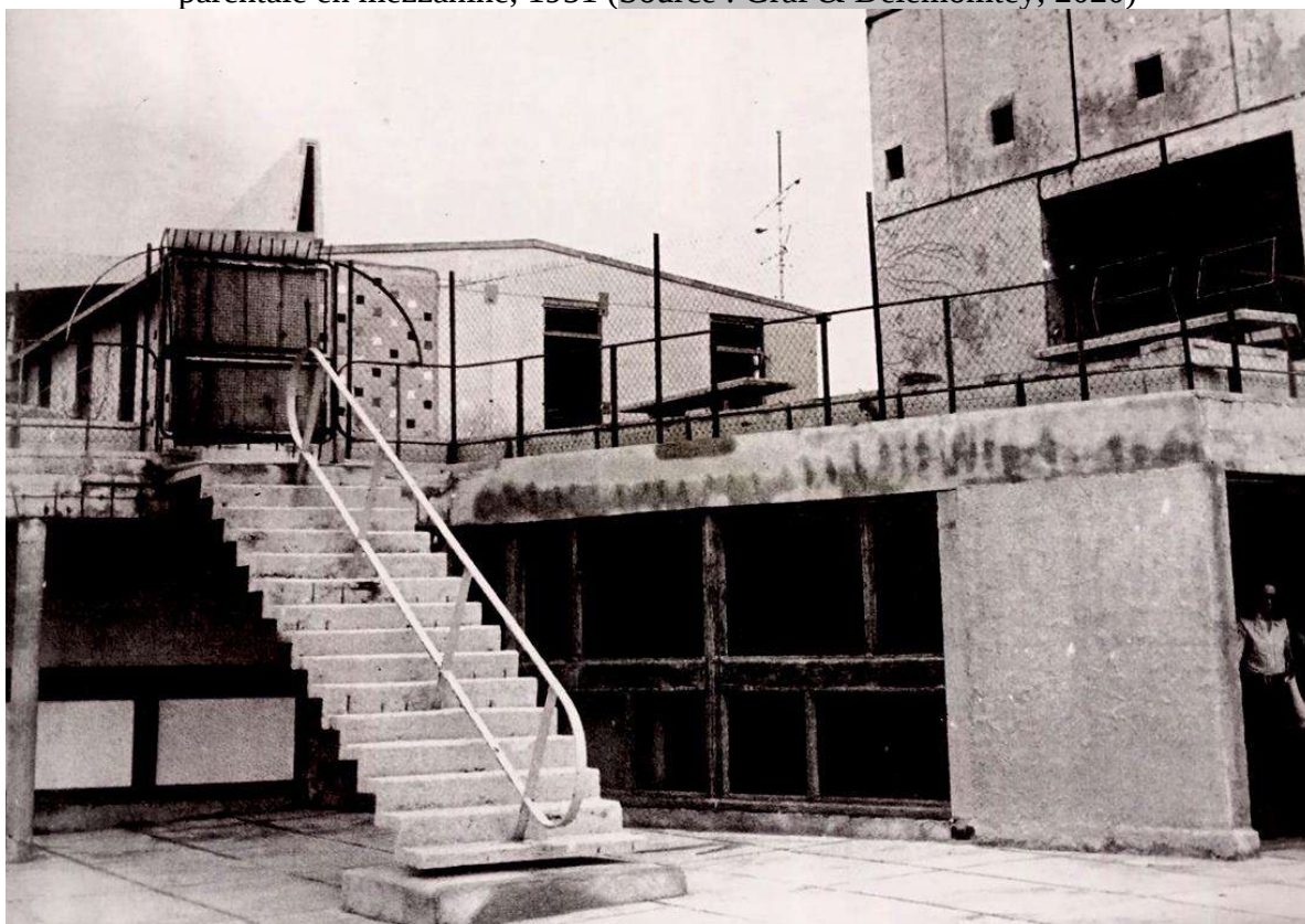
Fig.52. Etat de délabrement du solarium sur le toit-terrasse dans les années 1980 (Source : Graf & Delemomtey, 2020)
