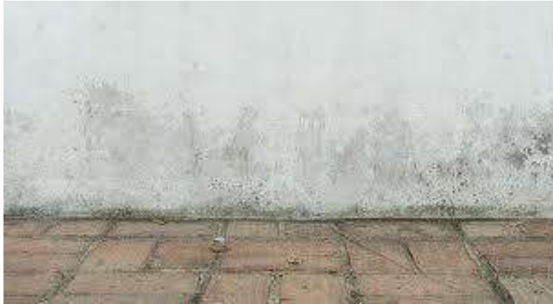
Fig.91. Dégradation de l'étanchéité
