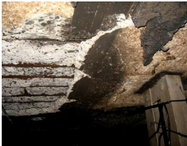
Fig.23. Eclatement de l'enrobage des armatures. Source : Abou Chakra, 2016
