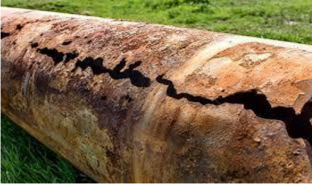
Figure 21 : Photo de la corrosion-érosion d'un tuyau.
