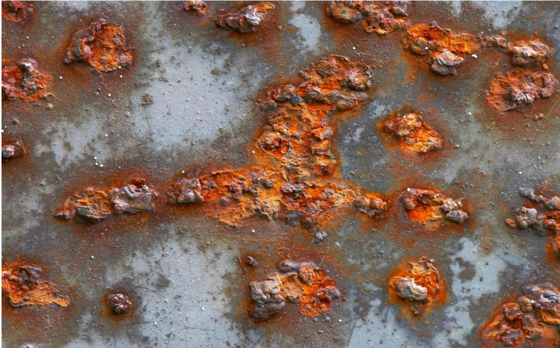
Figure 14 : Photo de la corrosion intergranulaire.
