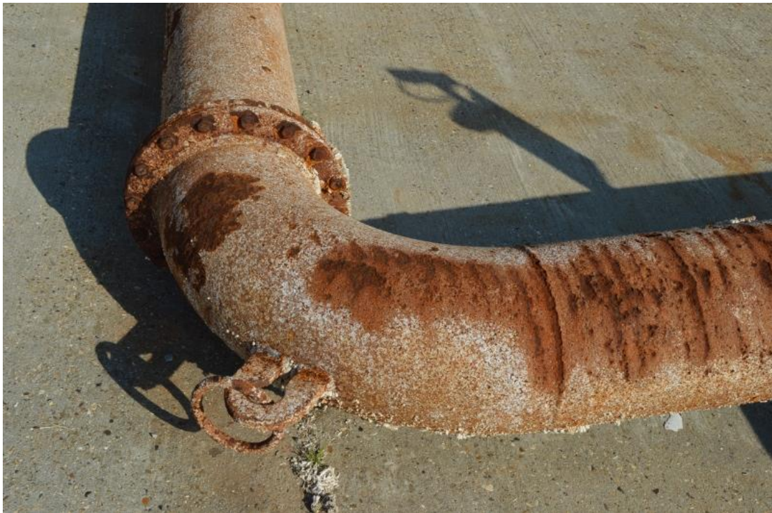
Figure 5 : Image d'un tuyau rouillé causé par l'eau de mer.
