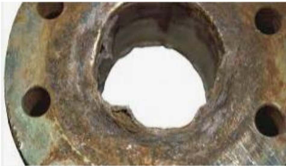
Figure 19 : Photo de la corrosion caverneuse.
