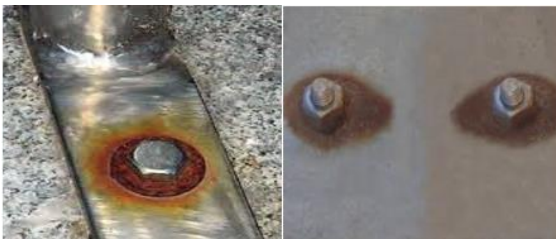
Figure 15 : Photos de la corrosion galvanique.
