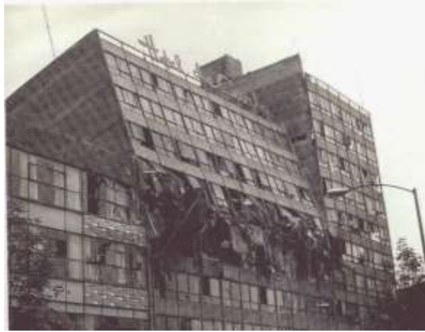
Figure 3.7 : Exemple de dommage dû à l'irrégularité en élévation (Variation des géométries).
