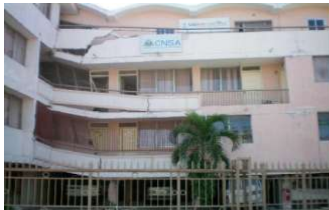
Figure 3.4 : Exemple de dommage dû à l'irrégularité en (Structure irrégulière de forme).
