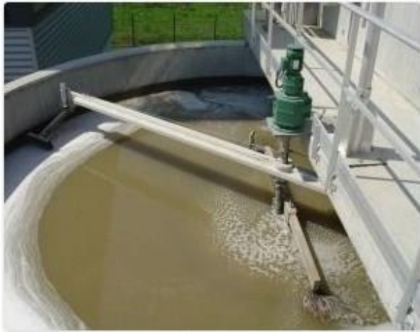
Fig III.3 Bassin dessabler/dégraisseur (google)
