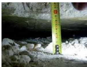
Figure 63. Affaissement de 9cm de l'isolant sous dallage et du remblai d'assise du dallage.
