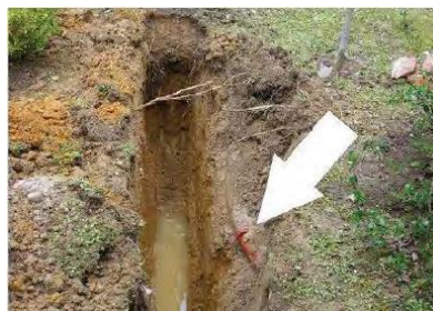
Figure 70. Arrivée d'eau par la tranchée des raccordements.
