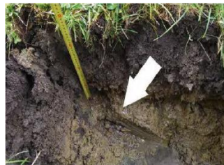
Figure 69. Veine d'eau découverte en amont de la construction à l'origine du mouvement différentiel.
