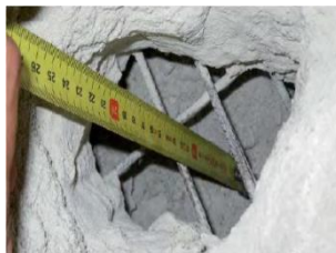
Figure 64. Défaut de calage du treillis soudé situé en partie basse du dallage.
