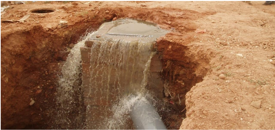
Figure 6. 1. Débordement de regard (Photographie de terrain)
