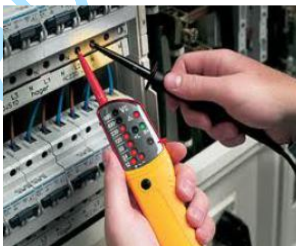
Mesure de la continuité des phases entre disjoncteurs dans un tableau électrique.
