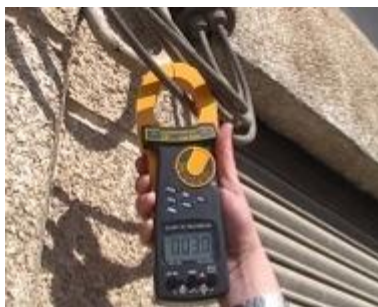
Pince ampèremétrique vérifiant le courant consommé durant une phase.
