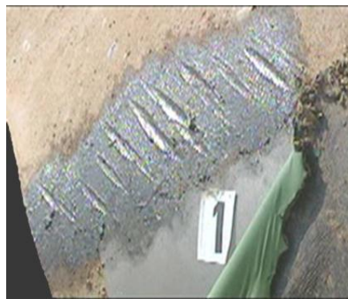
Figure II.2 : Exemple de pipeline contenant une entaille [10]
