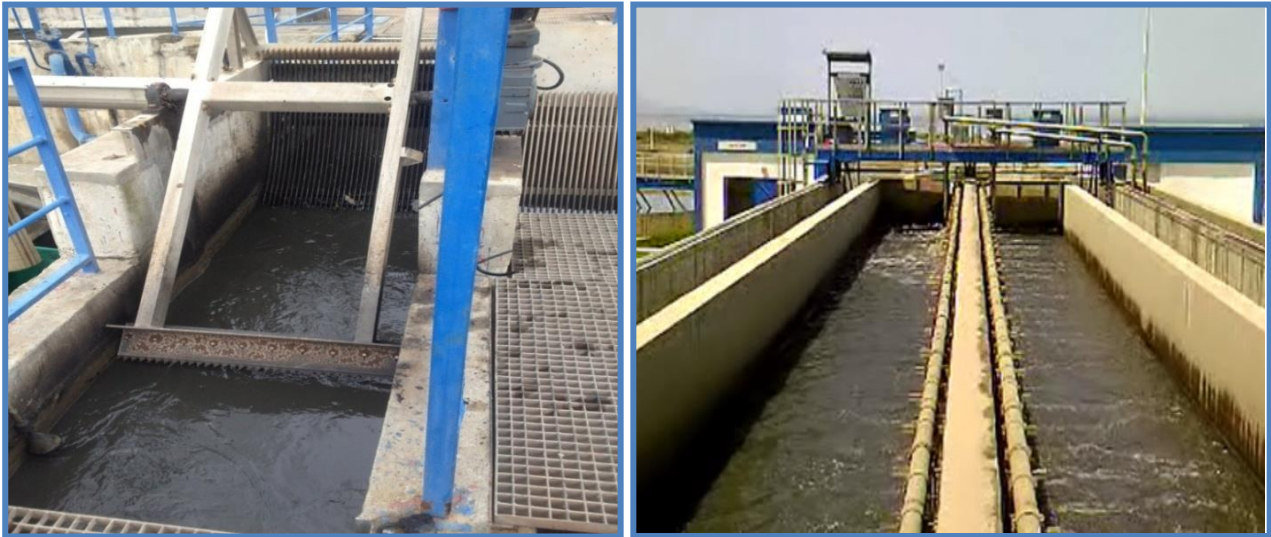
Figure4- Photo de Dégrilleur Photo de Désableur-Déshuileur
