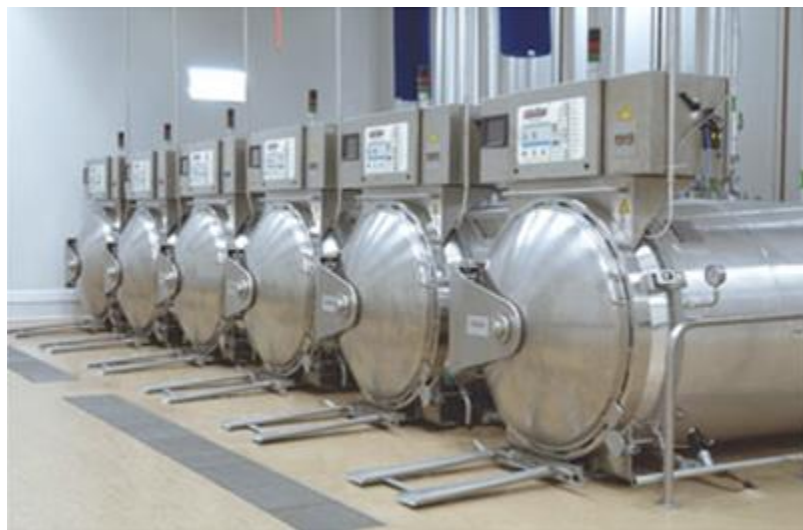
Figure 5 : Batterie d'autoclaves industriels
