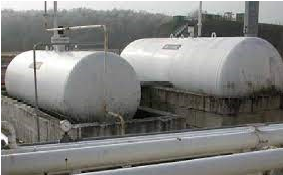
Figure I.2 : Bacs de stockage cylindriques horizontaux
