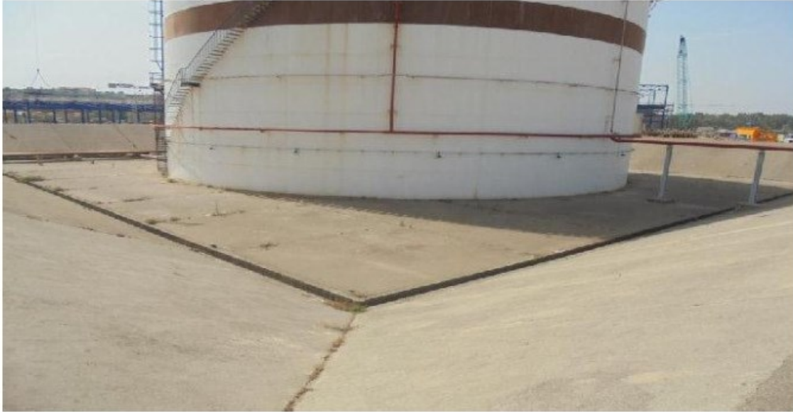
Figure I.12 : Cuvette de rétention
