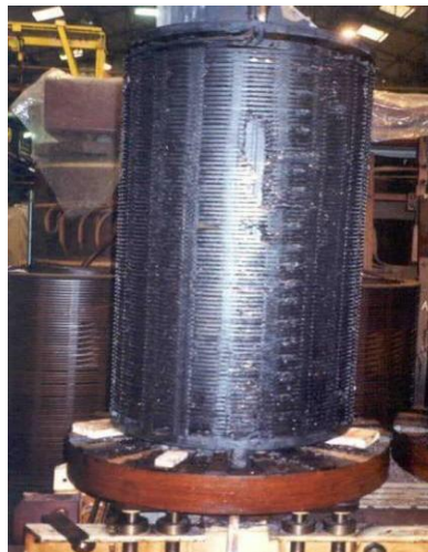
FIG. 4.15 – Echauffement excessif d'un enroulement
