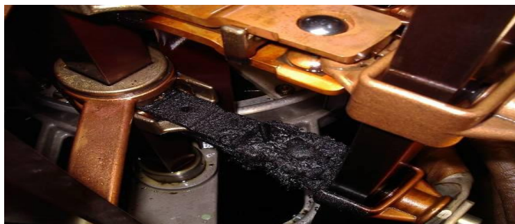
FIG. 4.12 – Point chaud du sélecteur du régleur en charge
