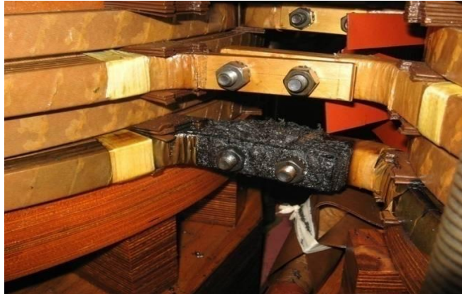
FIG. 4.13 – Point chaud sur connexion boulonnée
