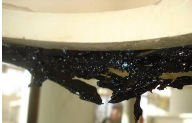
FIG. 4.14 – Joint de traversée écrasé
