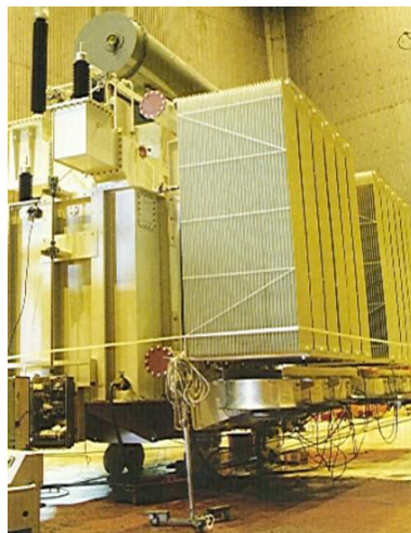
FIG.4.10– Radiateurs sur un transformateur
